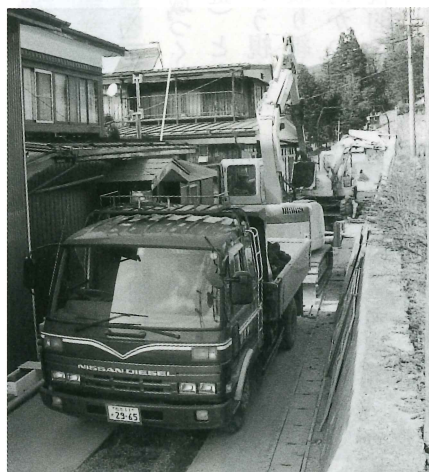
各町村で整備が進む公共下水道事業
