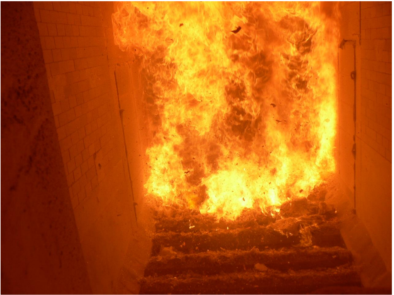
試運転(ごみの焼却)状況 (1号焼却炉)
