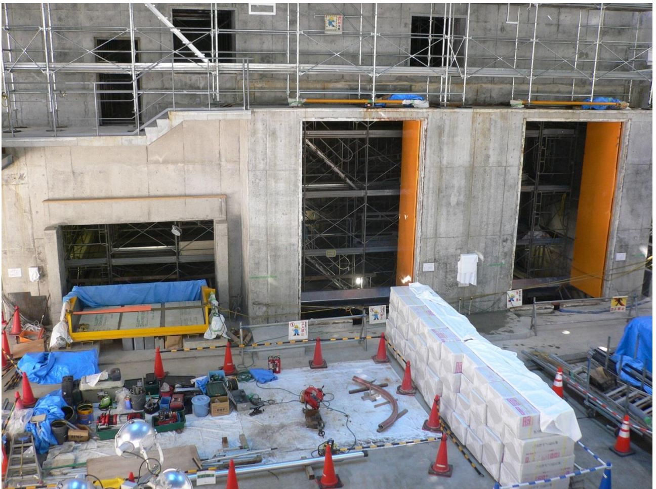
プラットフォーム内の施工状況 一番左側が一般持ち込み用の「ダンピングボックス」 右側二つがごみ収集車用の「投入扉」
